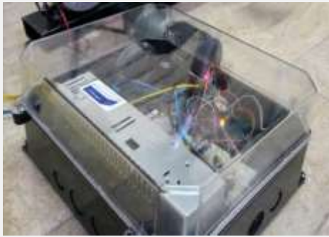
شکل (۸) - جعبه‌ی سیستم کنترل مرکزی
